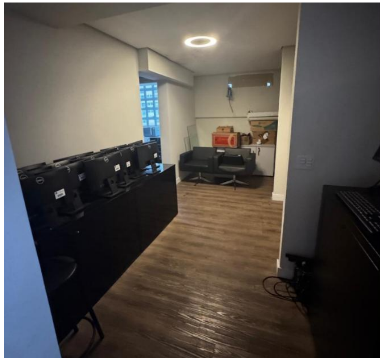
Servidor e depósito de maquinário da sede administrativa
